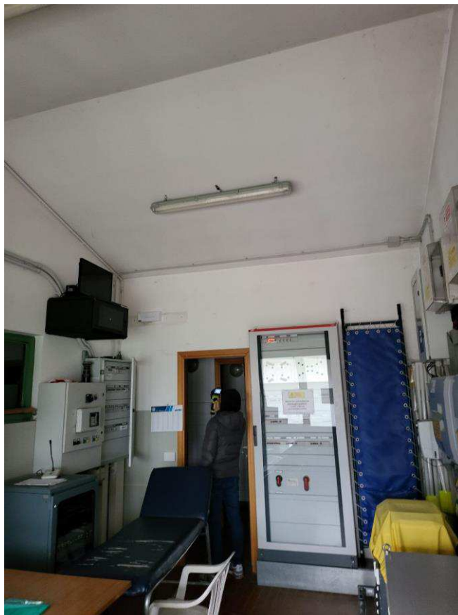
Foto 15 – Piano terra locale tecnico
