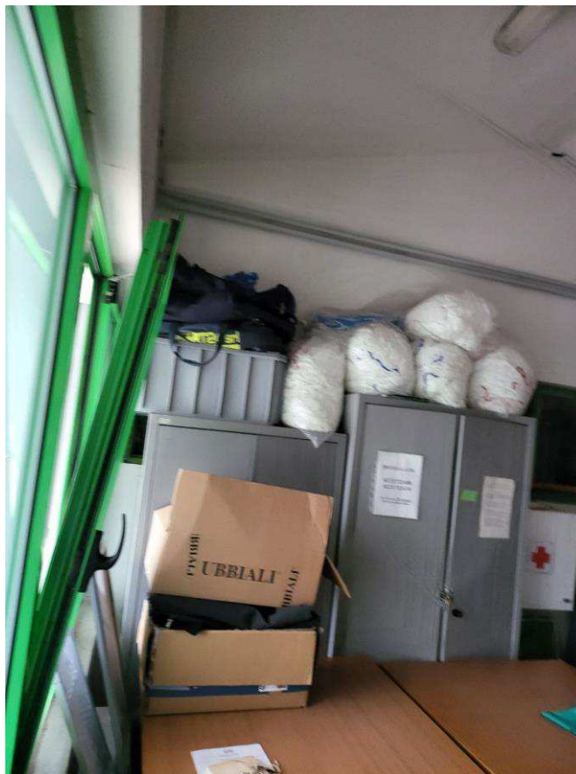
Foto 14 – Piano terra locale tecnico
