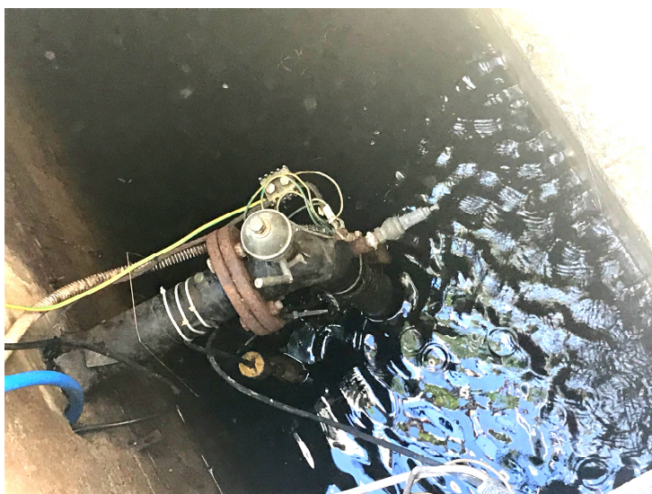
L'attuale cisterna per l'irrorazione e la pompa
